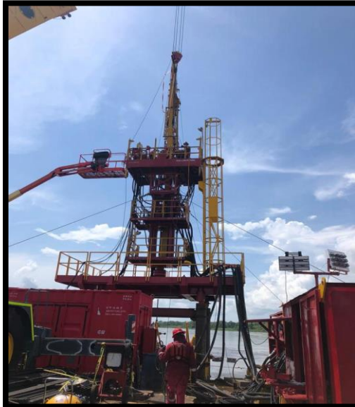
Figura 13. Unidad hidráulica en pozo Bajo Rio 2.
