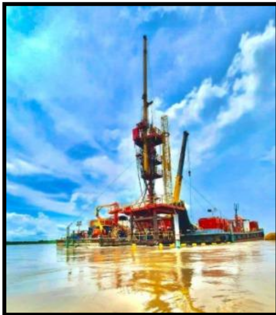
Figura 10. Equipos instalados en el pozo Bajo Rio 2.
