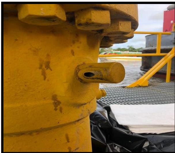
Figura 11. Hot tap exitoso sección A del cabezal.
