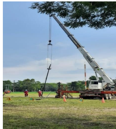
Figura 15. Asentamiento VRF helicoidales en fondo de pozo
