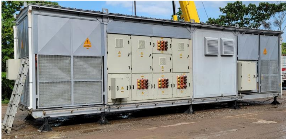
Figura 3. Switch Gear parte trasera.
