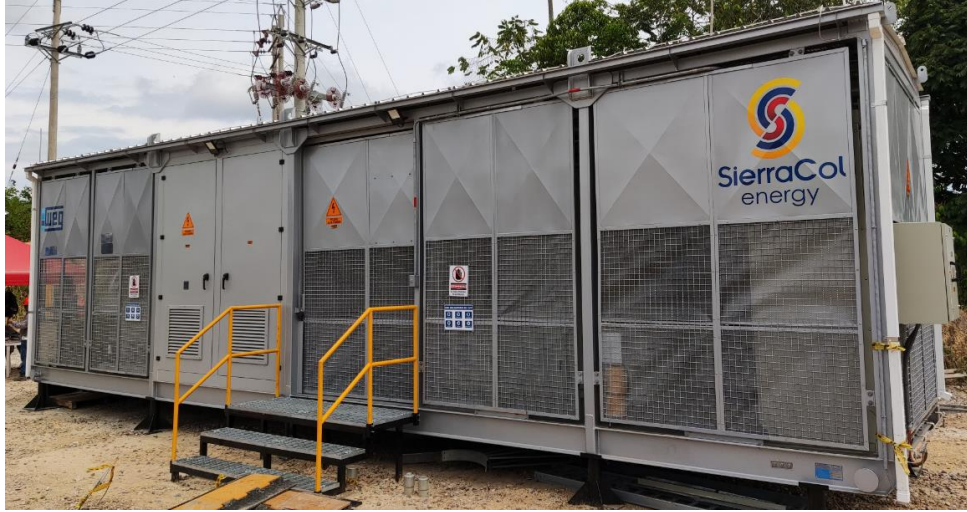
Figura 2. Switch Gear parte frontal.
